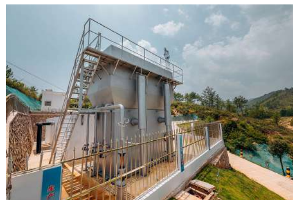
· 里东村一体化净水设备
